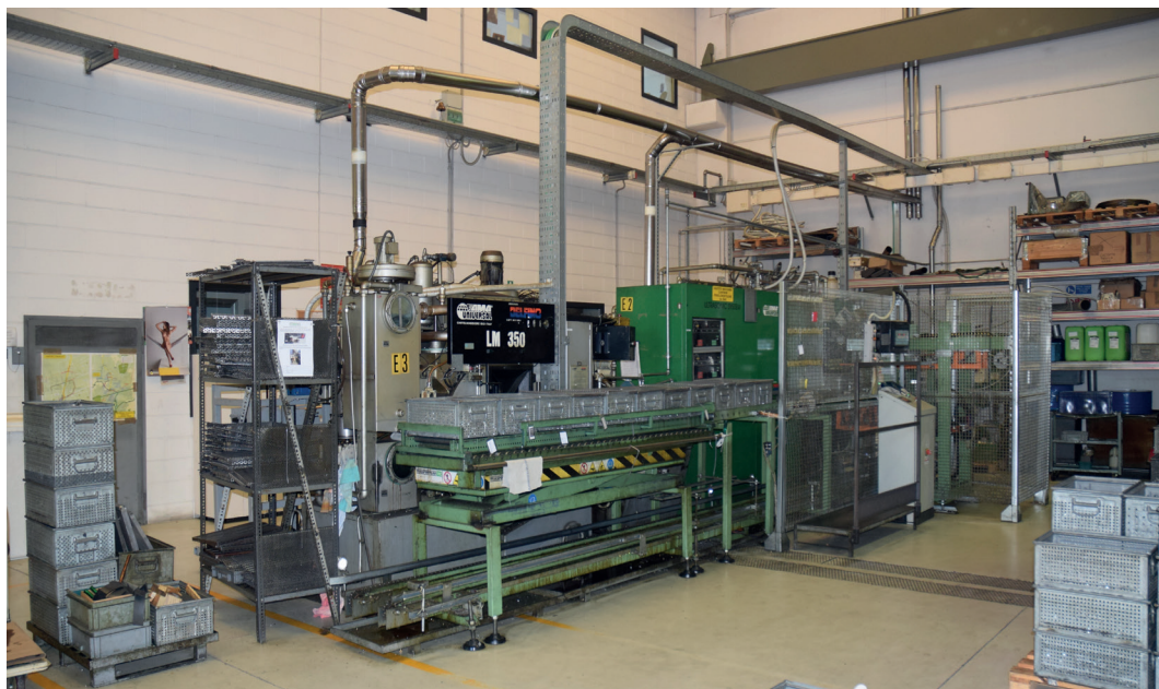
Vista impianti di lavaggio a ciclo chiuso forniti completi di automazione a Tornova da Dollmar.
