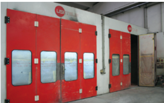
6 - La cabina di verniciatura pressurizzata.
